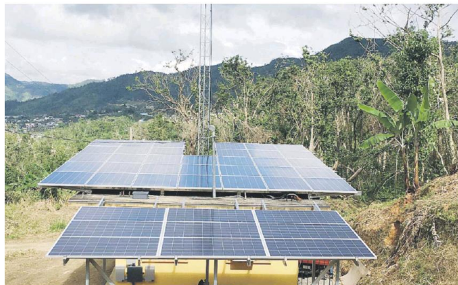
Placas solares energizan las operaciones de Radio Casa Pueblo, en Adjuntas.
